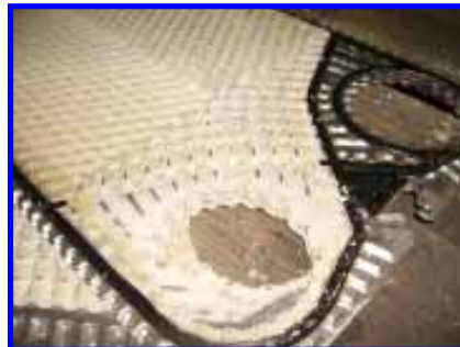
Stark verkalkter Wärmetauscher durch eine nicht abgelagerungsfreie Betriebsweise
