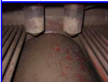
Vorher: Bei der Revision des Dampfkessels wurde Kalkbelag und Korrosion beanstandet
